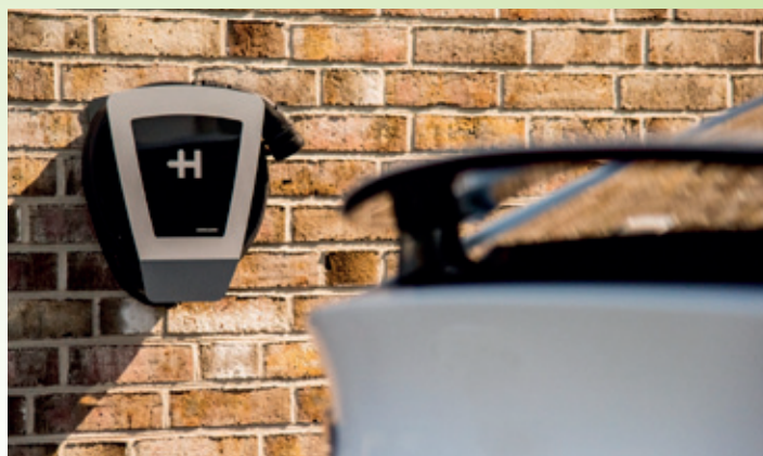
Mit einer festinstallierten Wallbox als Ladeeinrichtung wird ein Elektrofahrzeug sicher und schnell auch zu Hause geladen. Foto: Heidelberger Druckmaschinen AG
