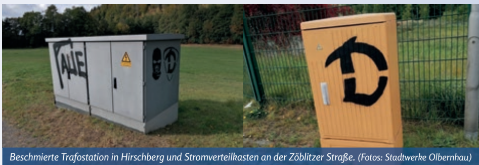
Selbst vor der künstlerisch gestalteten Trafostation am Gymnasium Olbernhau, die in einem Projekt von Schülern bemalt wurde, macht der Vandalismus nicht halt.
