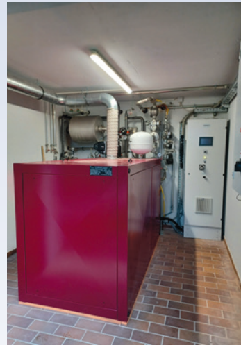
Das BHKW auf der Kläranlage Olbernhau Foto: Stadtwerke Olbernhau GmbH
